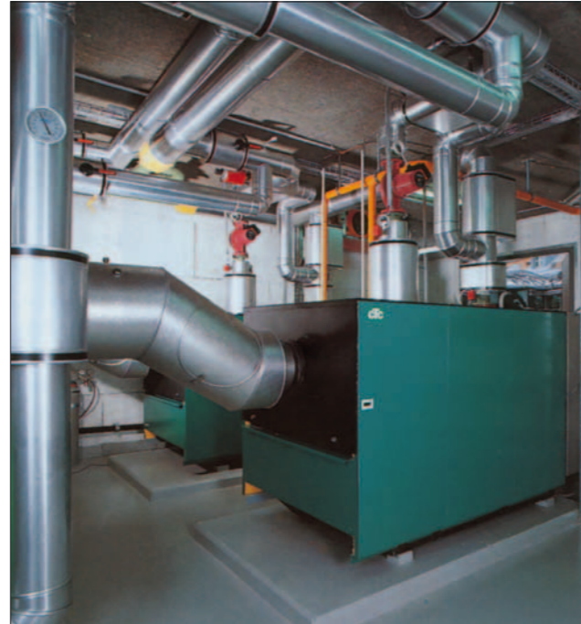
Heizanlage mit 2 CTC Heizkesseln in einem Einkaufszentrum
